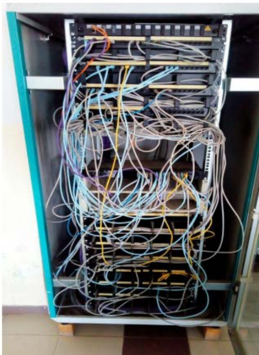
SG0046_RACK ZONA C AULA 2-5
